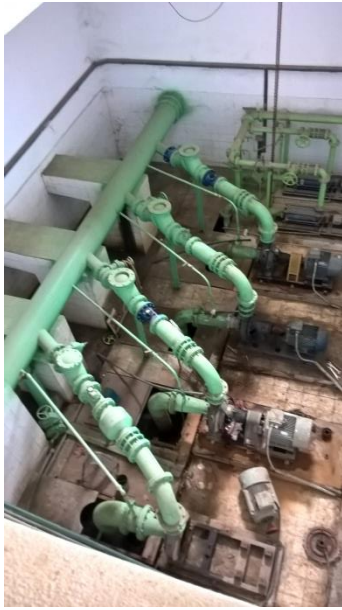
Station de pompage du réseau REUSE
