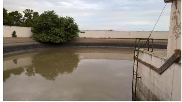
Bassin de stockage des eaux usées traitées
