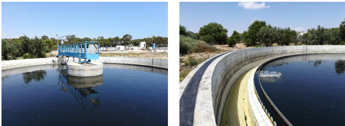
Figure 9 : Bassin de clarification
