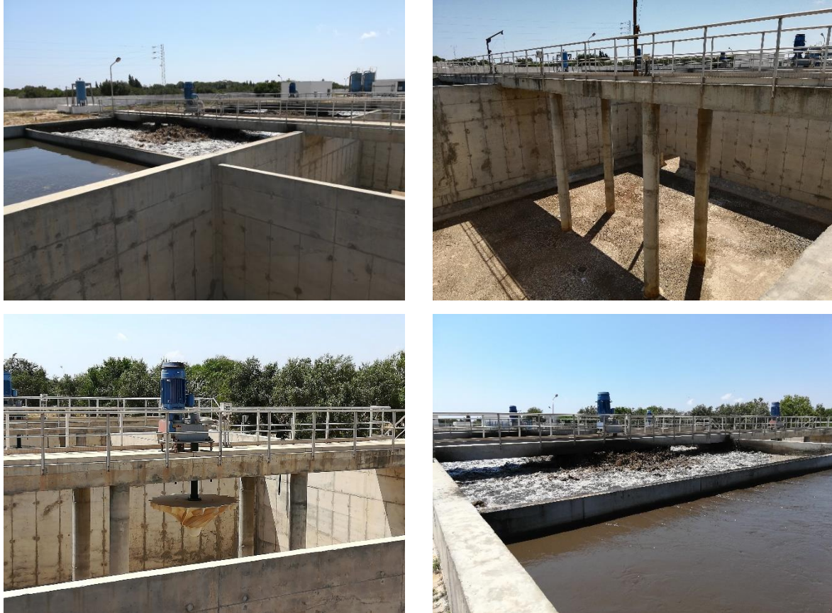
Figure 8 : Deux files de 3 bassins d'aération en série, équipés d'aérateurs (une file en réserve)
