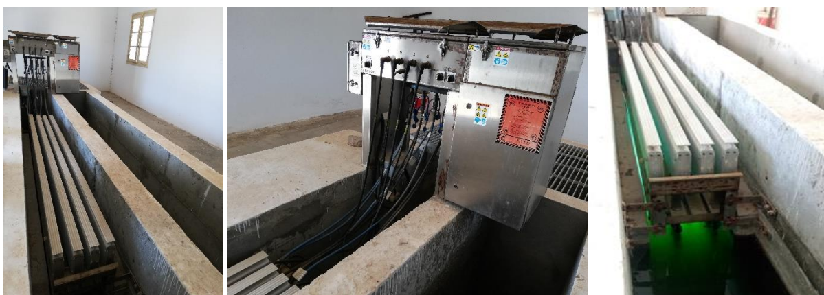
Figure 11 : Lampes UV (non opérationnelles en juillet 2019, réparées en novembre 2020)
