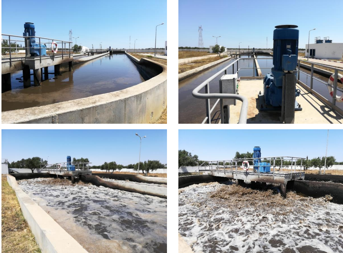
Figure 8 : Bassin d'aération composé d'un chenal d'aération en U
