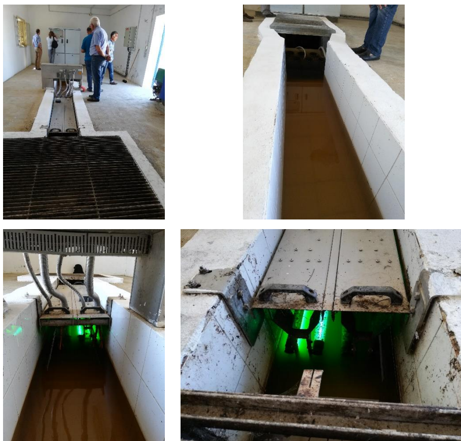
Figure 11 : Traitement UV, partiellement défectueux (juillet 2019)
