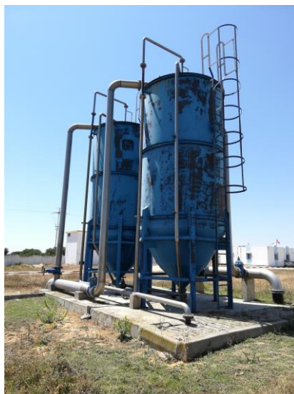
Figure 10 : Filtration à sable sous pression
